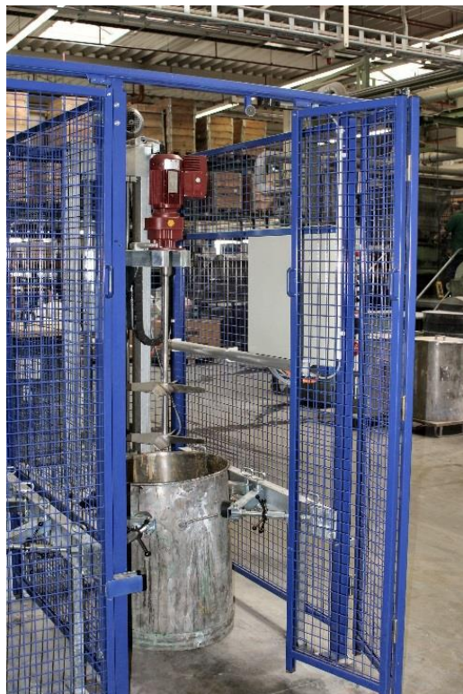
Bild 5: Durch (verriegelte) trennende Schutzeinrichtungen gesichertes Rührwerk
